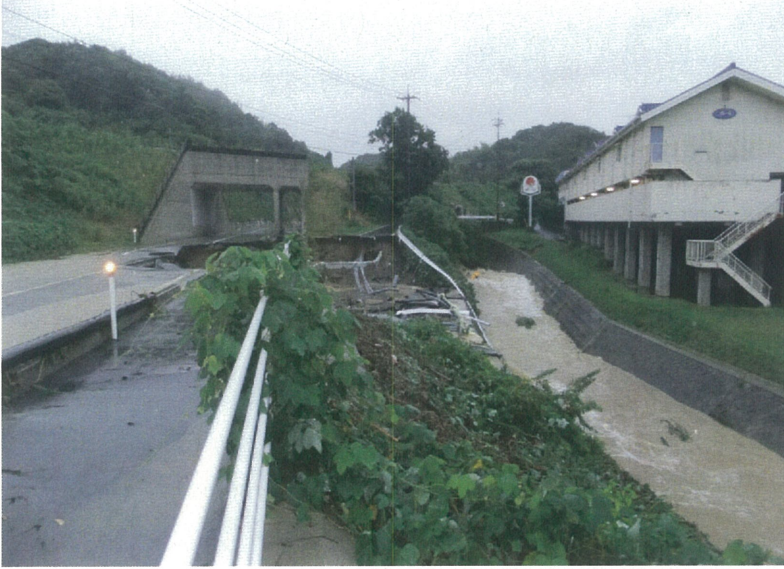
◆江津市波子町地内の被災現場 (県道跡市波子停車場線)
